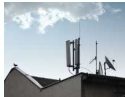
2. ábra. Mobiltelefon-antenna pesti háztetőn
